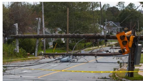
Lignes électriques endommagées à Dartmouth, en Nouvelle-Écosse (photo : SaltWire/Ryan Taplin).
